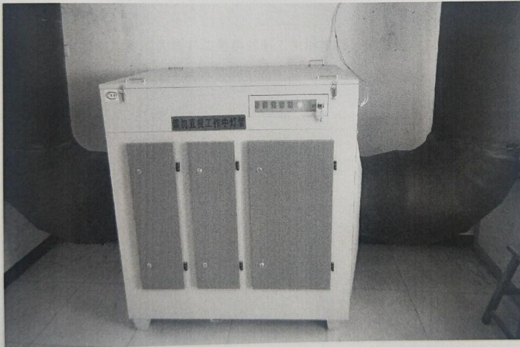
图 3-1 废气处理设施现场照片
